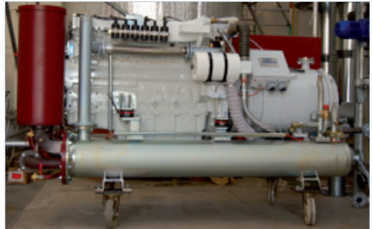
Dezentrale Kraft-Wärme-Kopplungsanlage der SWP im Pforzheimer Emma-Jäger-Bad.
