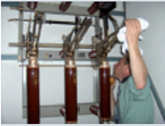
Schäden an den Anlagen können hohe Ausfallzeiten nach sich ziehen, deshalb müssen sie regelmäßig gewartet werden.
